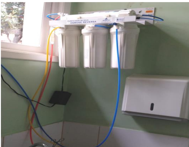
Figura 43: Sistema de purificação de água.
